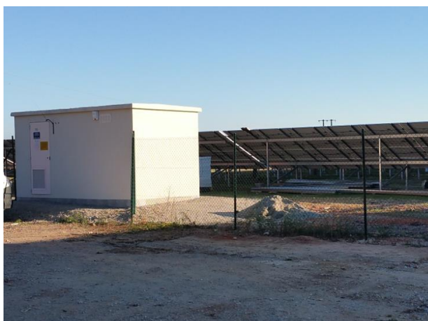
Exemple de poste de transformation sur un parc solaire (Luxel, 2017)
