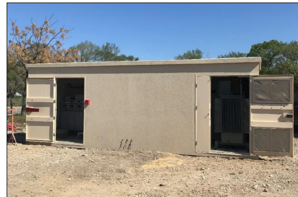
Figure 17 : Exemple de postes de transformation et de livraison HTA/BT (Source : VALECO)
