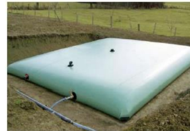
Figure 7: Exemple de réserve d'eau artificielle souple
