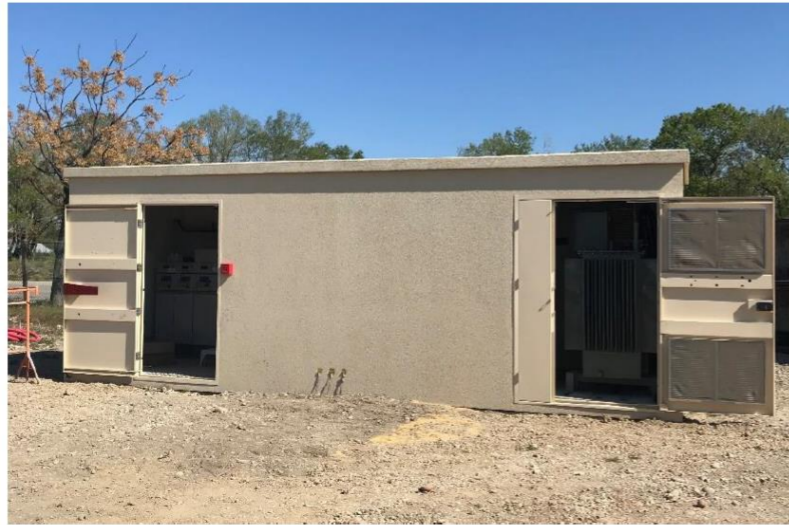
Figure 6: Photographie d'un poste électrique
