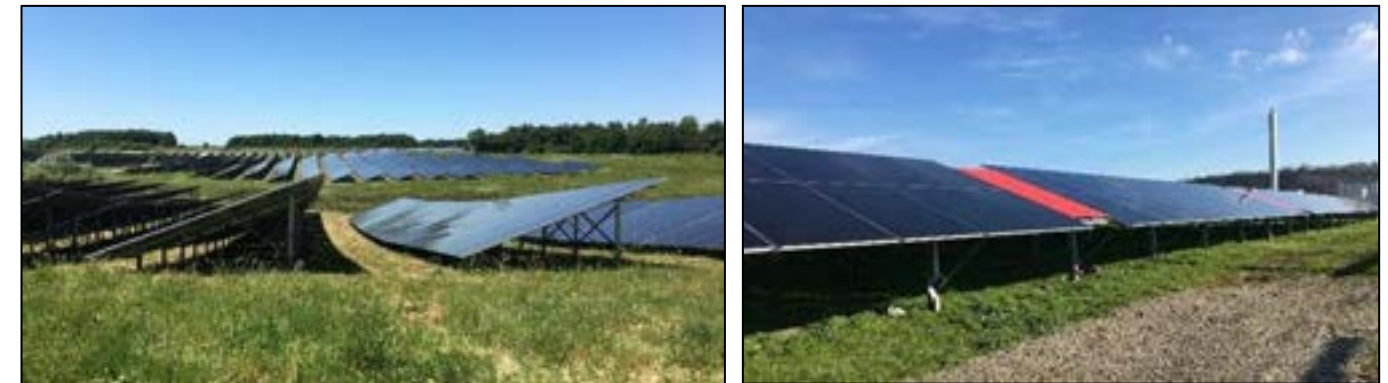
Figure 40 : Exemples de réalisations URBASOLAR : Nersac (16) et l'Oncopole de Toulouse (31) (Source : URBA 436)
