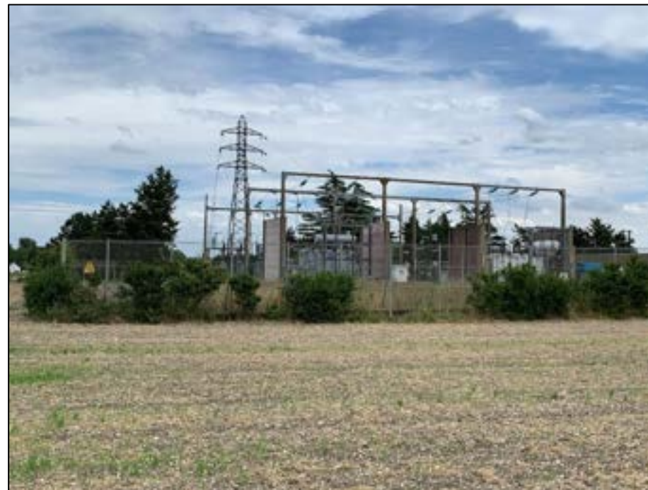
Vue E' : Vue sur le poste source au nord du site du site.
