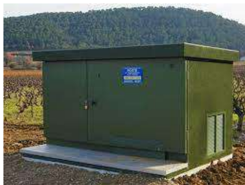
Exemple de poste de livraison vert
