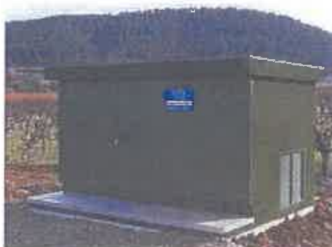
Exemple de poste de livraison vert
