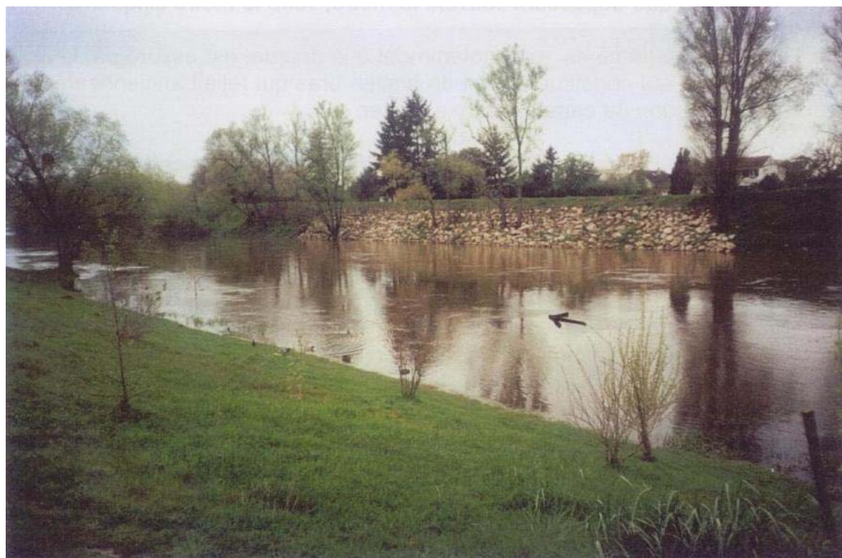
Levée de terre de l'Abricot en rive droite, localement protégée par des enrochements.
