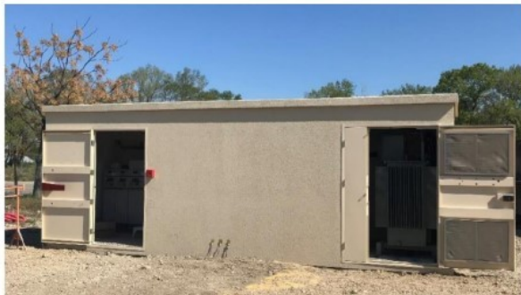
Photo 26 : Exemple d'un poste de livraison/transformation (Source : Valeco)
