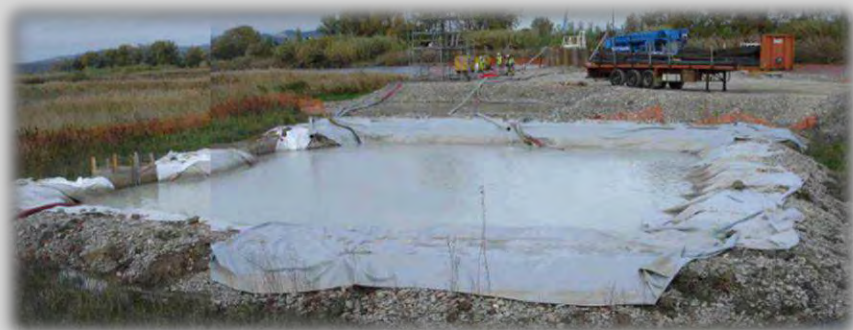
Figure 73 : Bassin provisoire de décantation des MES et autres polluants (Source photo : ADEV Environnement)
