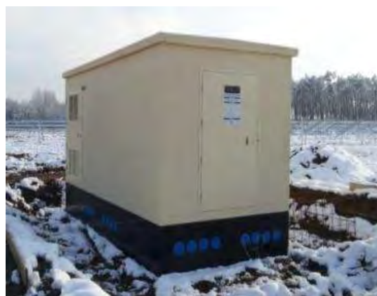
Photo 108 : Exemple de poste de livraison
