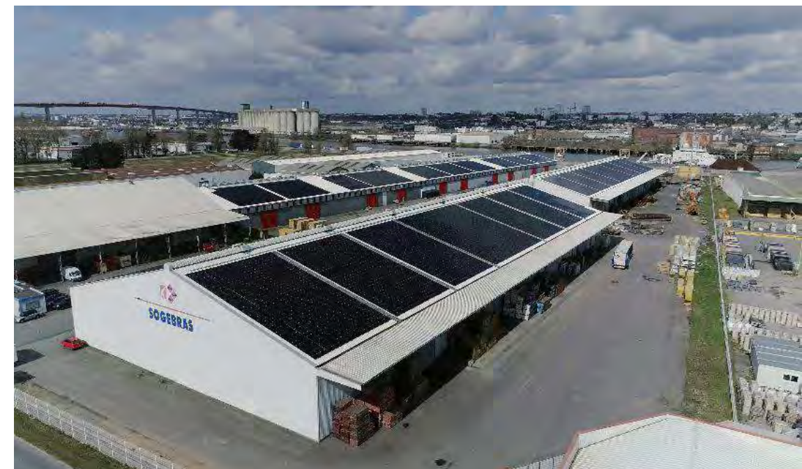
Photo 5 : photovoltaïque en toiture de Cheviré
