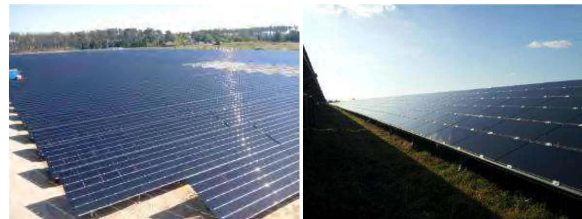
Photo 6 : Centrale photovoltaïque de Carcen Ponson – Août 2014
