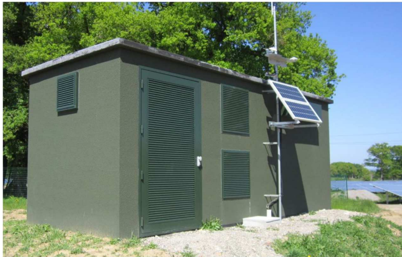
Exemple de poste de livraison
