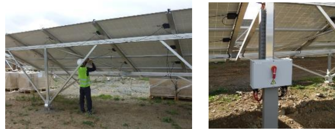
Photo 29. À gauche : Câblage des panneaux – A droite : Boitier de raccordement
