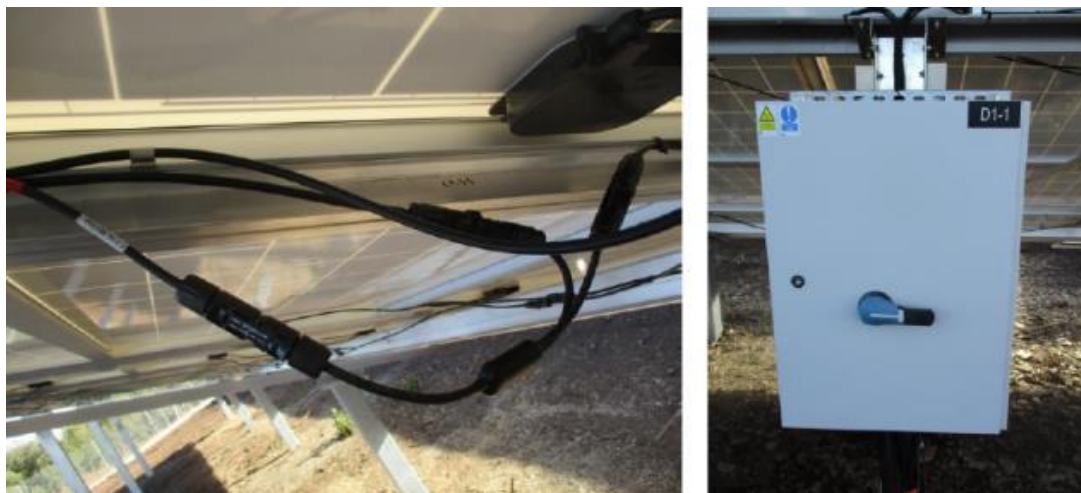
Photo 21. Exemple de câble électrique et de boîte de raccordement
