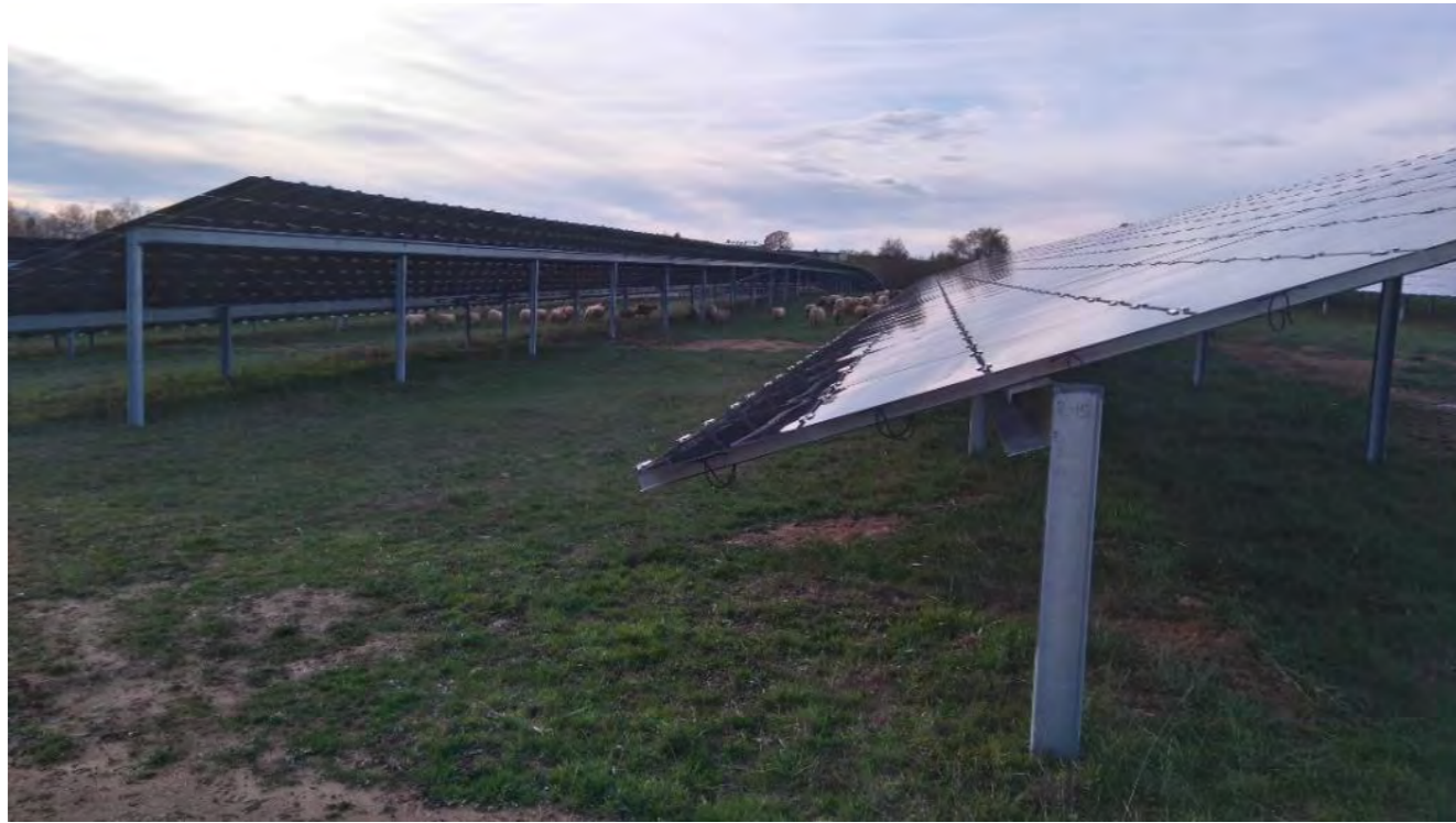
Exemple de la centrale photovoltaïque au sol de Saint-Eusèbe (71) – complémentarité entre pâturage d'ovins et photovoltaïque (source JPEE)
