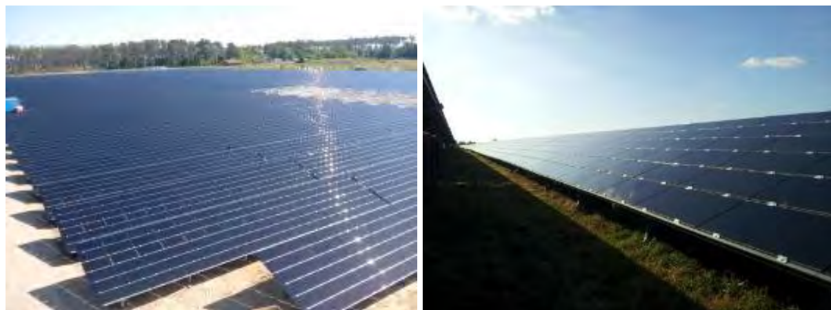
Photo 12 : Centrale photovoltaïque de Carcen Ponson – Août 2014
