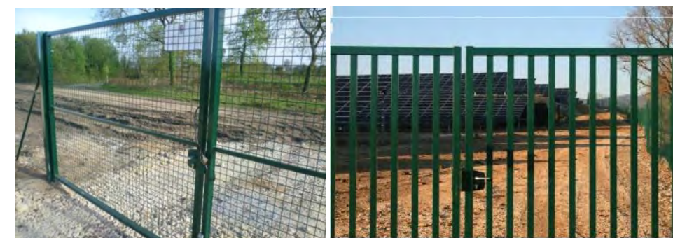
Photo 74 : Exemples de portails d'accès aux sites photovoltaïques
