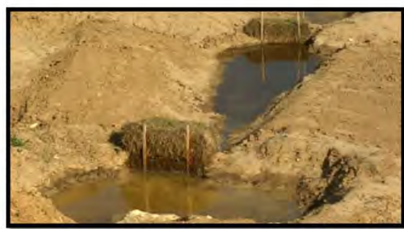
Filtre à paillet et bassin de décantation
