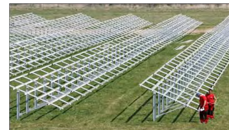
Photo 62 : Exemple de châssis fixes orientés sud
