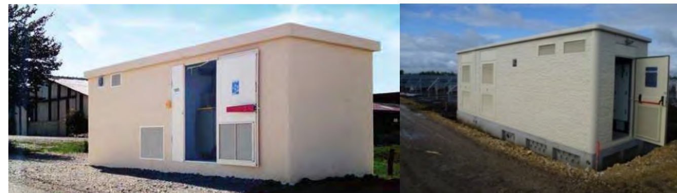
Photo 70 : Exemples de locaux techniques abritant les postes de transformation Source : JPEE
