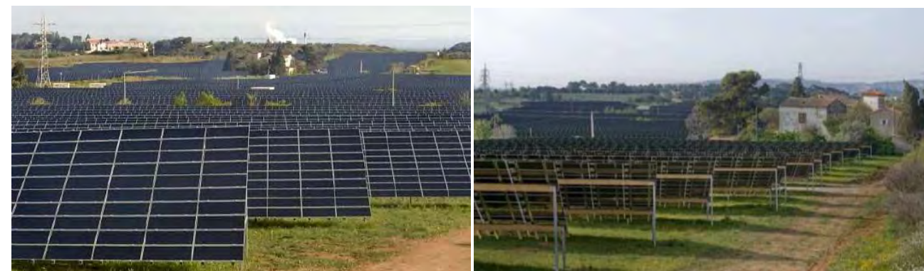
Photo 80 : Illustrations montrant le développement de la végétation sous les panneaux photovoltaïques
