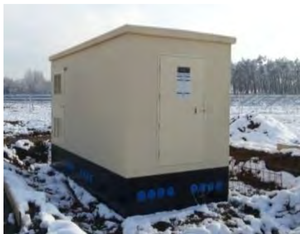
Photo 72 : Exemple de poste de livraison
