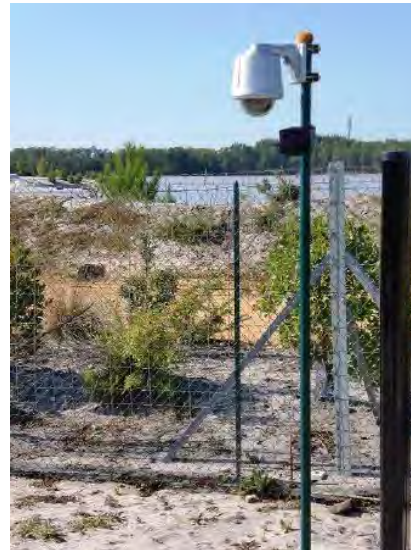
Photo 75 : Caméra de surveillance Source : JPEE
