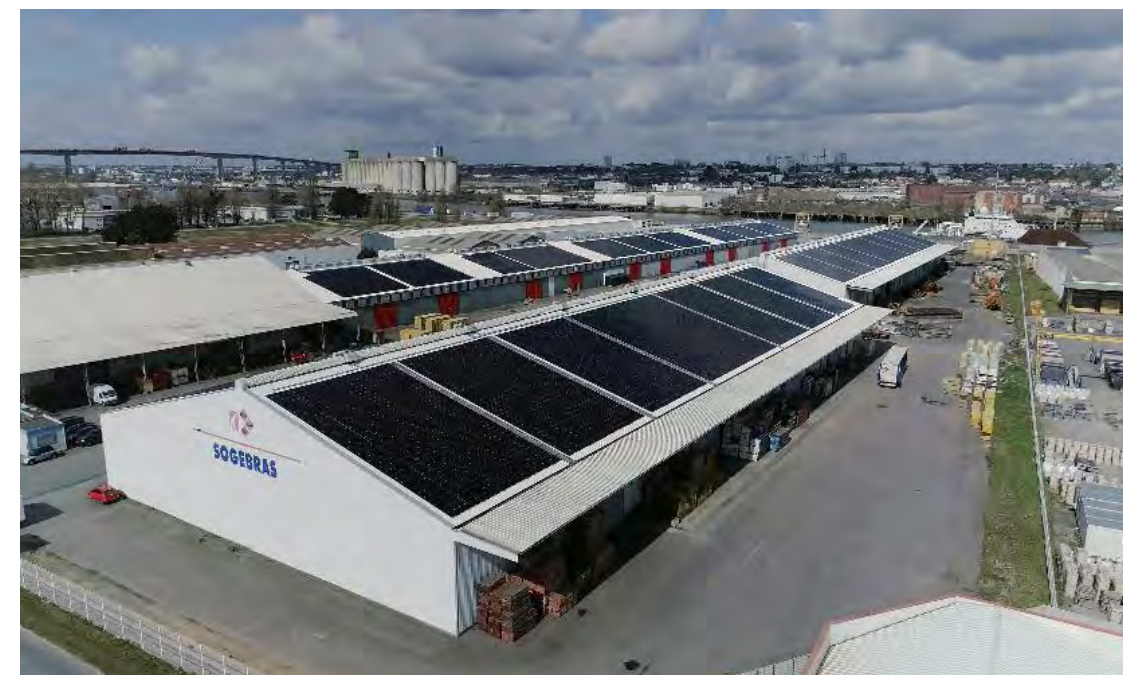
Photo 11 : photovoltaïque en toiture de Cheviré
